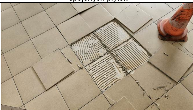
Fot. 8 – brak zarysowań konstrukcji po usunięciu odspojonych płytek
