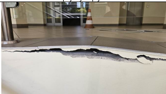
Fot. 10 – odspojenie na krawędzi płyty stropowej piwnicy
