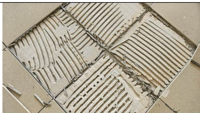
Fot. 7 - brak zarysowań konstrukcji po usunięciu odspojonych płytek
