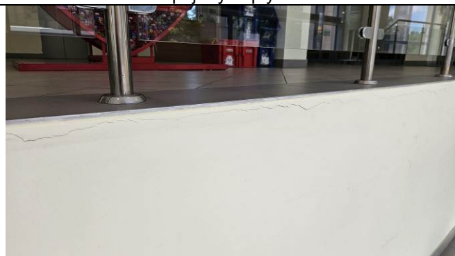
Fot. 9 – odspojenie na krawędzi płyty stropowej piwnicy
