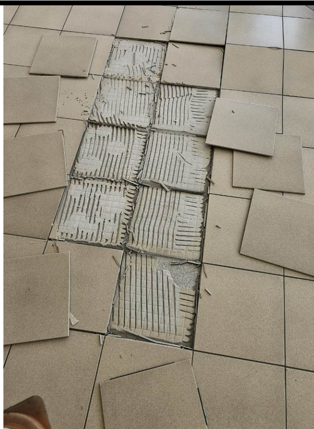
Fot.6 – brak zarysowań konstrukcji po usunięciu odspojonych płytek
