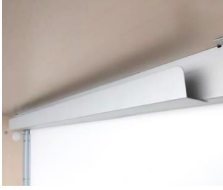
rys. 7- kanał kablowy z rynną kablową
